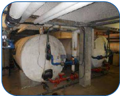
Ballon d'eau chaude sanitaire vétuste dans un des bâtiments.
